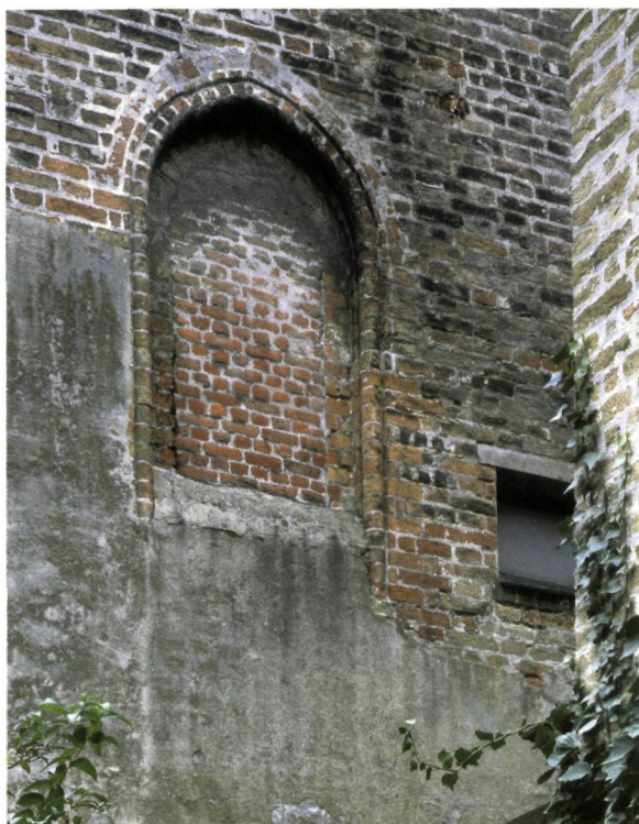
▶ Spiegelrei 5: dichtgemaakt spits- boogvenster in de linker zijmuur (foto O. Pauwels)
