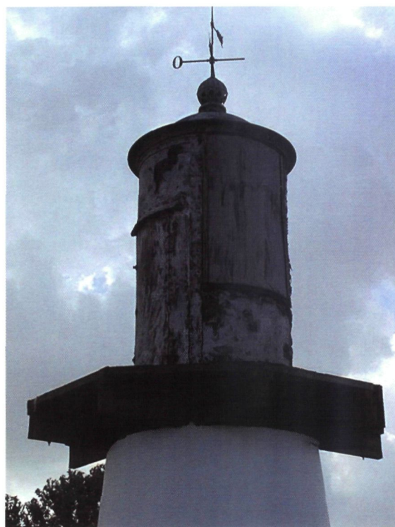
▲ De lantaarn van het Laag Licht vóór restauratie (Driesen-Meersman-Thomas architecten)
