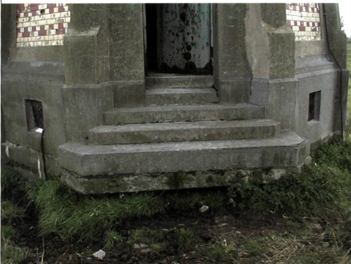
▲ Schadebeeld van de verzakking van de mote van het Hoog Licht, gefundeerd op palen (Driesen-Meersman-Thomaes architecten)
