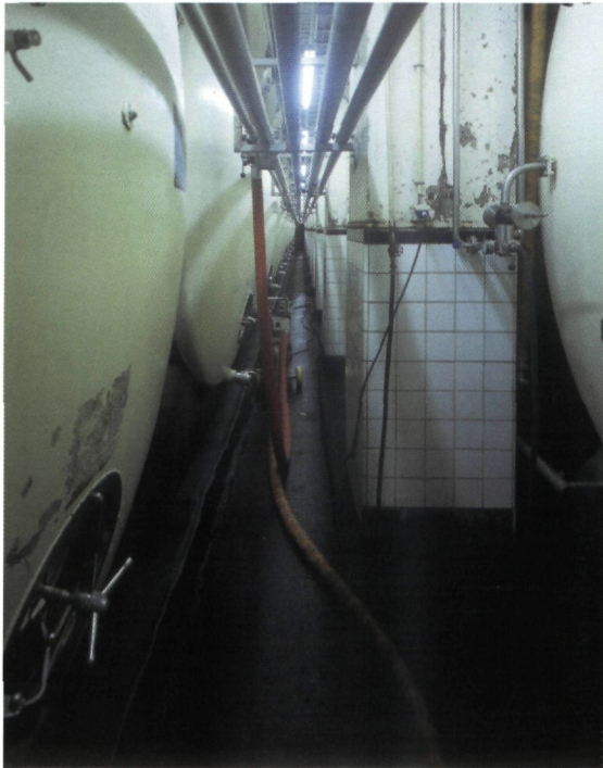
▲ Stalen lagertanks voor jong bier, uit 1935, nog in gebruik. Dit deel van de lagerkelders wordt in de komende jaren gerestaureerd (foto O. Pauwels)
