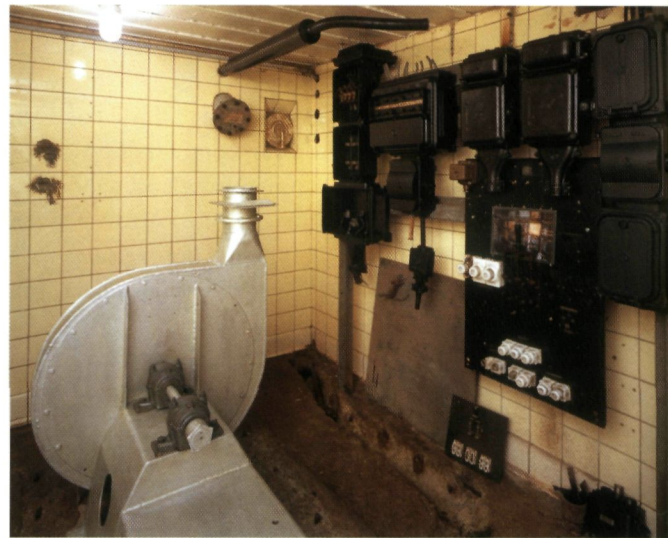
▲ De machinekamer met de dieselmotor voor het opwekken van electriciteit (foto O. Pauwels)
