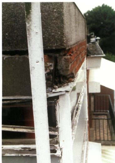
► Hoek badkamer: toestand ramen en metselwerk erboven
