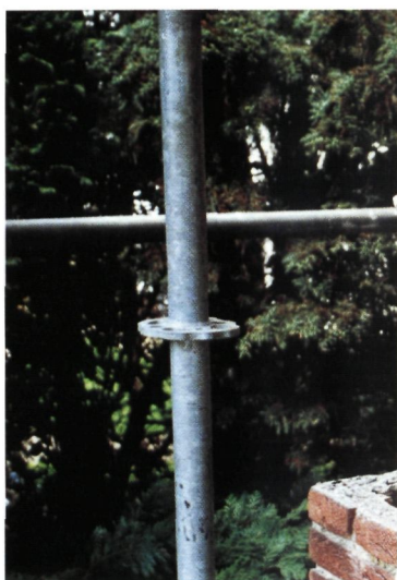
▲ Demontage kolom- bekleding: de bak- stenen komen volledig los van het beton
