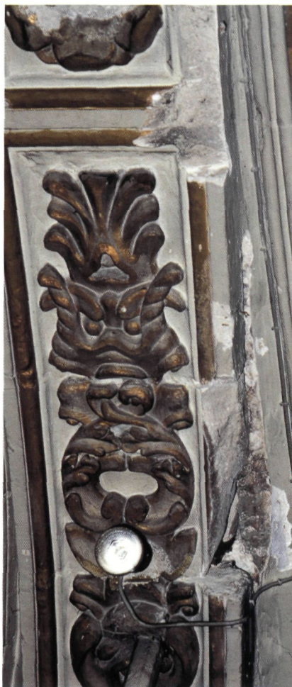
◀ Zoutschade op de bogen van het gewelf (foto O. Pauwels)
