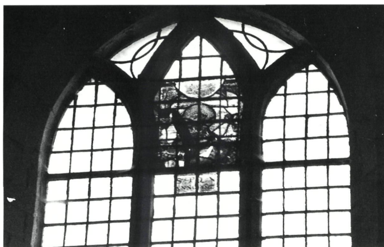
◀ Toestand van de glaspanelen in situ, 1983 (foto Y. Vanden Bemden)
