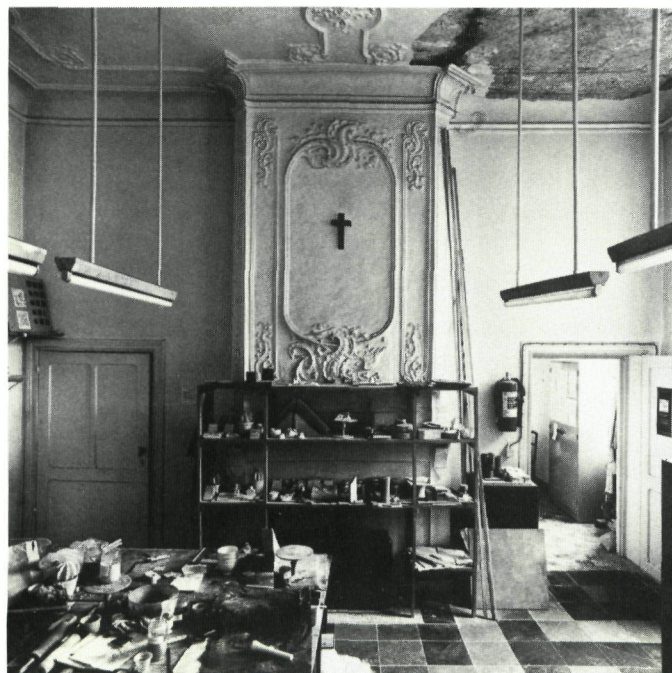
Toestand van de lokalen toen het gebouw nog in gebruik was als muziek- en tekenacademie. Sterk beschadigd 18de-eeuws stucwerk in de tussenvleugel van het Waerdenhof (foto F. Somers)
