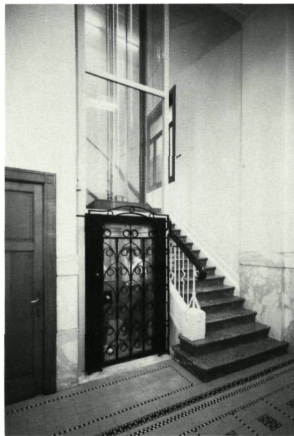
Liftschacht van het merk Jaspar, bouwjaar 1926, gerenoveerd met een glazen schachtscherming en deurbekleding, bij Van Doosselaere & Achten, Van Meteren-kaai 4, Antwerpen (foto G. Charlier)
