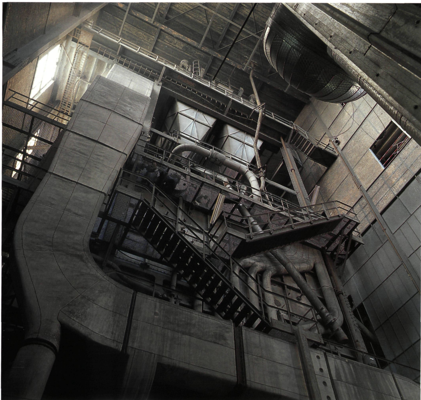
Zicht op één van de drie Cockerill-ketels van de elektrische centrale van Houthalen die nauwelijks 23 jaar in werking bleef. Ze werd pas begin 1950 gebouwd omdat deze mijn voor haar schachtafdieping elektriciteit kon afnemen van het gemeenschappelijke U.K.E.C.-veiligheidsnet van de andere koolmijnen. Na de sloping van de koeltorens onlangs ... zal deze centrale vermoedelijk binnenkort hetzelfde lot ondergaan (foto E.D.)
