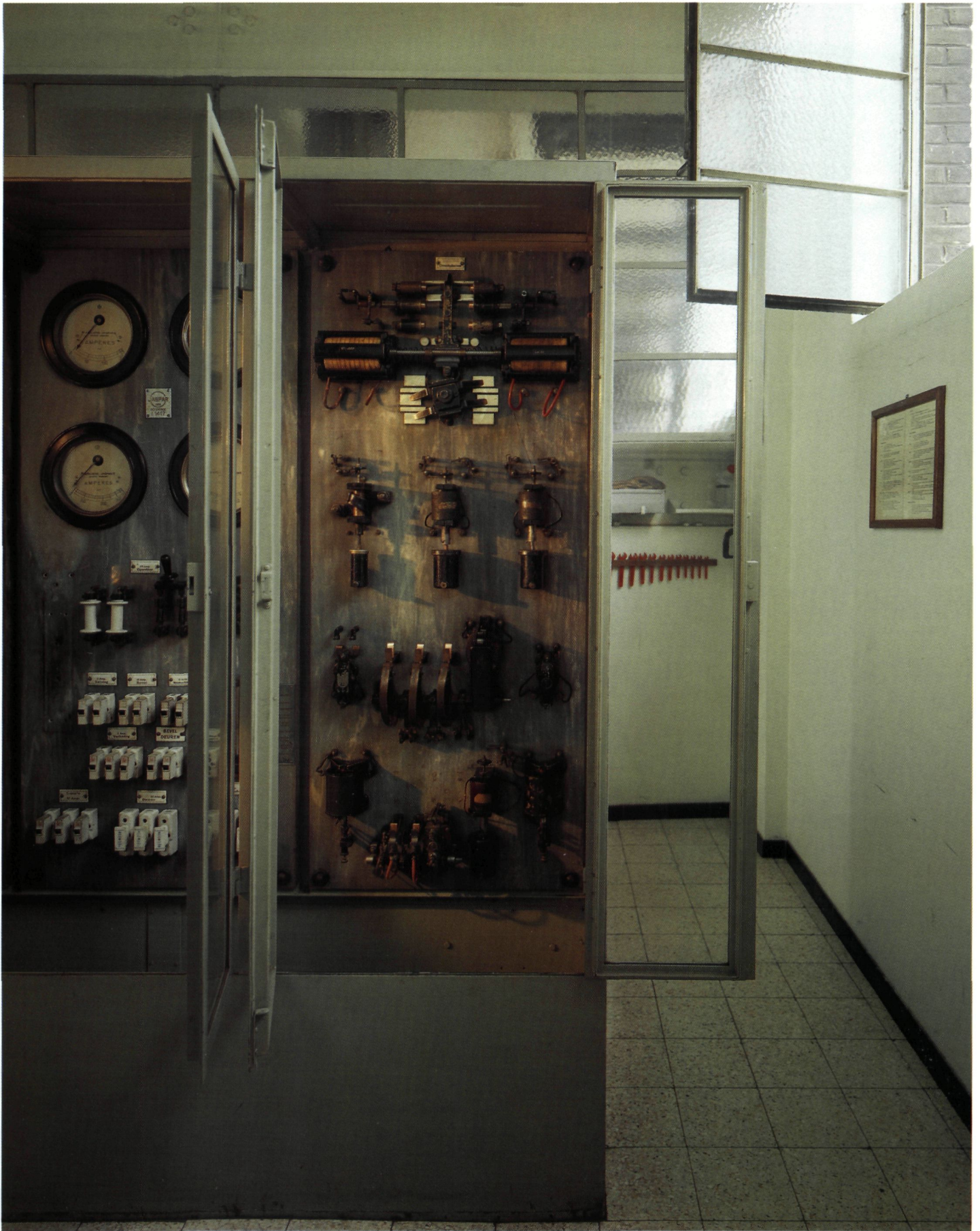
Machinekamer van de lift — merk Jaspar, bouwjaar 1933 — in de IMALSO-voetgangerstunnel onder de Schelde, te Antwerpen (foto G. Charlier)
