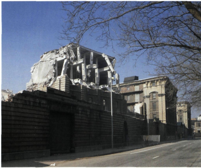
De afbraak van het Koninklijk Stapelhuis laat een blik toe op de vroegste betonnen vloeren, balken en kolommen (foto O. Pauwels)
