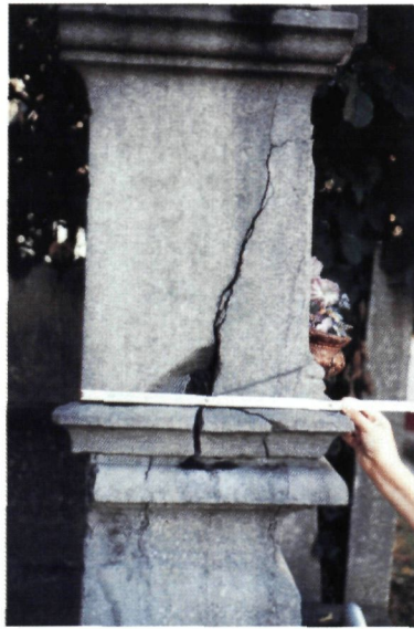
De gebarsten nis (eigen foto)
