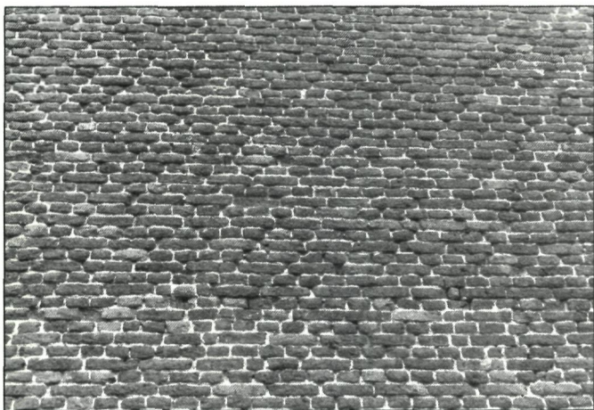
Toestand metselwerk mei 1984 (zijgevel). Bij de bouw werd een veldovensteen gebruikt van minderwaardige kwaliteit die sterk onderhevig is aan weersinvloeden. Aangezien de voorgevel gekalkt was, werd bij de restauratie de voorgevel na reiniging gekaleid met een verdunde metsel-specie. Zodoende konden vervangingen tot een minimum worden herleid. Hierop werd geschilderd. De zijgevels werden plaatselijk hersteld en hervoeegd daar geen enkel spoor er op wees dat zij ooit afgewerkt werden (foto B.M.L.).
