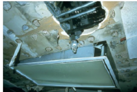
d) Olive View, daño en instalaciones
