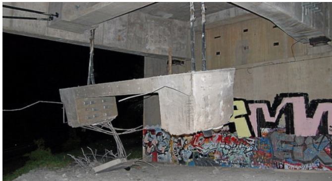
Bild 4.3: Abgerissener Endverankerungsblock an der Talbrücke Sechshelden kurz nach Fertigstellung [Hell11]
