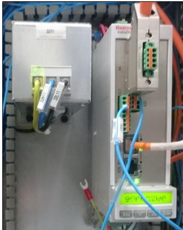
Figura 6.7: Controlador de motor à direita, com a fonte de alimentação do motor à esquerda.
