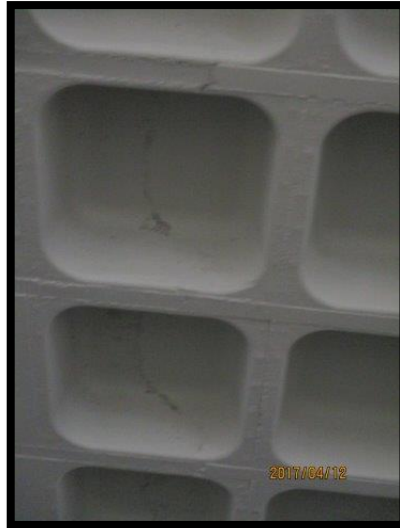
Figura 121 – Continuação das patologias identificadas na pintura dos cocos no teto do piso 0
