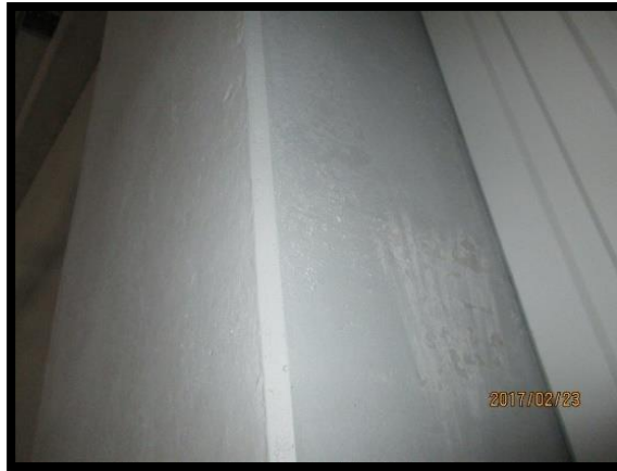
Figura 118 - Patologias identificadas na pintura dos pilares pré-fabricados do piso 2
