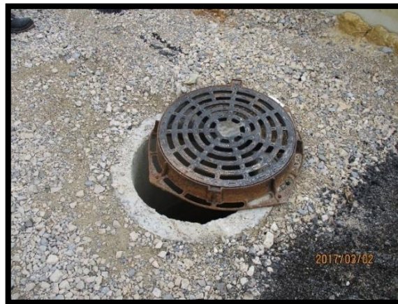
Figura 147 - Ausência de guardas e sinalização na caixa de visita
