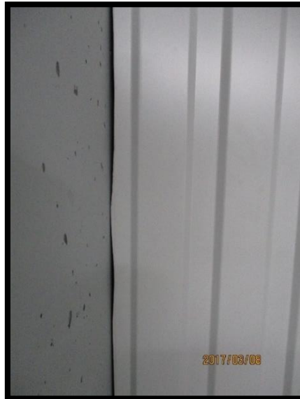
Figura 134 - Identificação de patologias na chapa de contra fachada do piso 2
