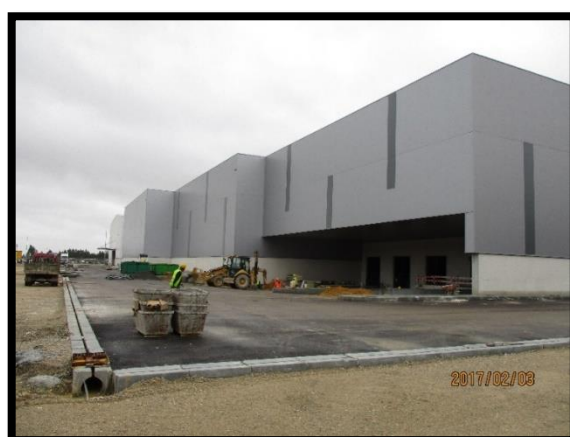
Figura 65 - Montagem da caleira de balão pré-fabricada da rede de drenagem de águas pluviais na zona do cais
