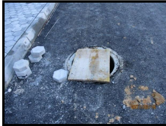
Figura 146 - Ausência de guardas e sinalização na caixa de visita no pavimento
