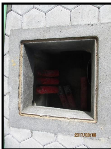
Figura 63 -Caixa de visita da rede de drenagem de águas residuais (vista interior)
