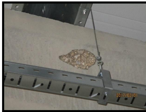
Figura 122 – Patologias identificadas nas vigas delta pré-fabricadas do piso 2
