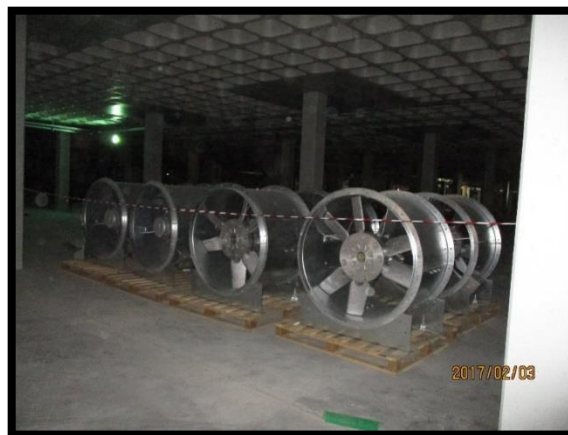
Figura 79 - Hélices de ventilação do projeto AVAC
