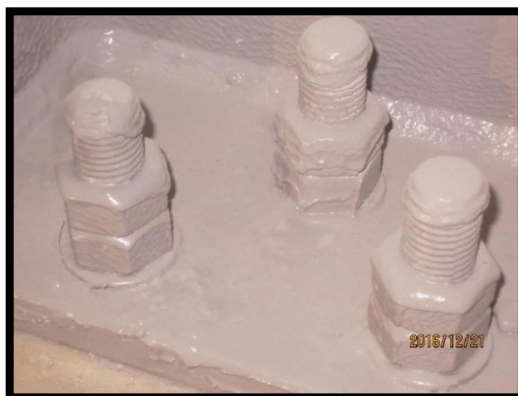
Figura 132 - Parafusos excessivamente cobertos com tinta corta-fogo nos pilares metálicos do piso 1
