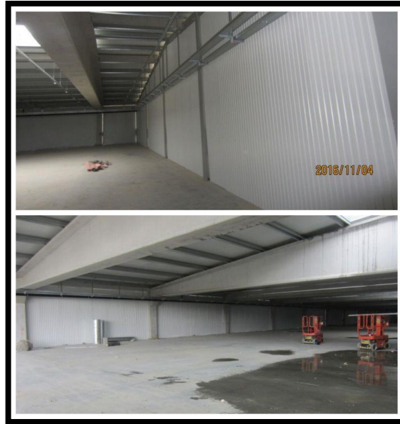
Figura 31 - Chapa de contra fachada no Piso 2
