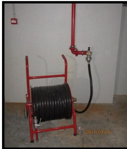
Figura 80 - Rede de incêndio armada com carretel no interior do edifício da Unidade de Armazenamento e Logística
