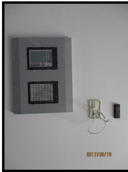
Figura 83 - Equipamento SADI para detecção de incêndio e equipamento de controle de acessos
