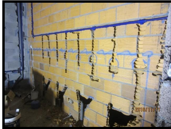
Figura 56 - Abertura de roços para a passagem da rede de abastecimento de água
