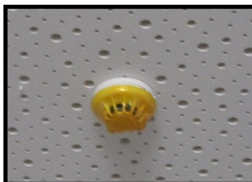
Figura 82 - Alarme de incêndio na zona administrativa
