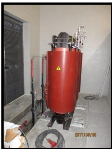
Figura 92 - Posto de transformação localizado na zona administrativa
