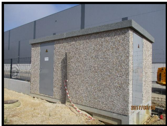
Figura 91 - Posto de seccionamento localizado na entrada do empreendimento
