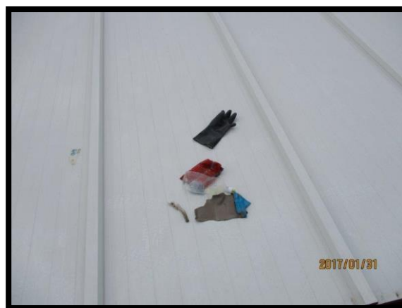
Figura 124 - Identificação de lixo na cobertura
