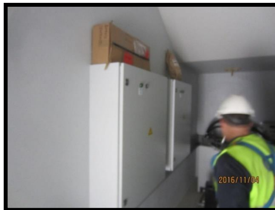
Figura 84 - Casa das máquinas dos monta-cargas
