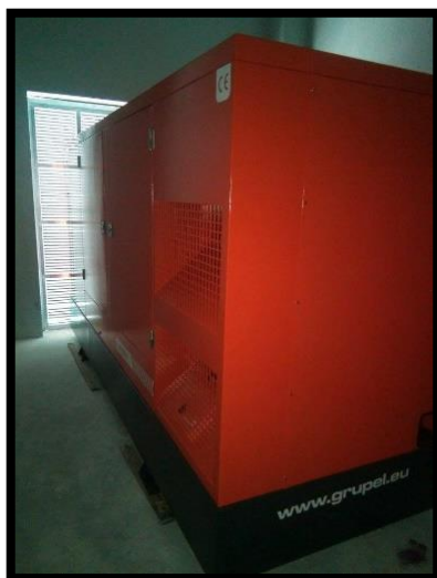
Figura 93 - Gerador de energia localizado na zona administrativa
