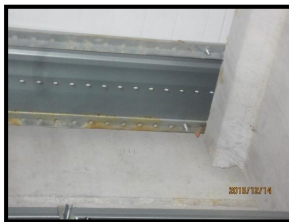
Figura 126 - Identificação de patologias nas madres Madremax que suportam os painéis de cobertura
