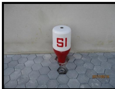
Figura 81 - Marcos de incêndio aplicados no exterior
