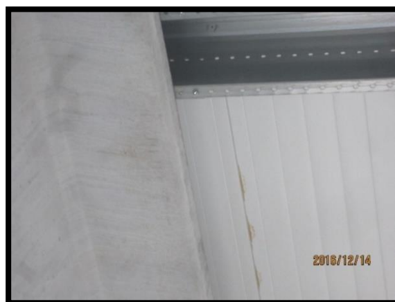
Figura 127 - Identificação de patologias no painel de cobertura (vista do piso 2)
