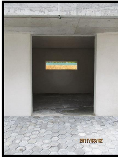
Figura 104 - Revestimento interior do grupo de bombagem
