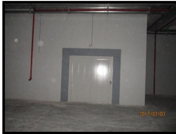
Figura 88 - Aspeto dos monta-cargas já instalados
