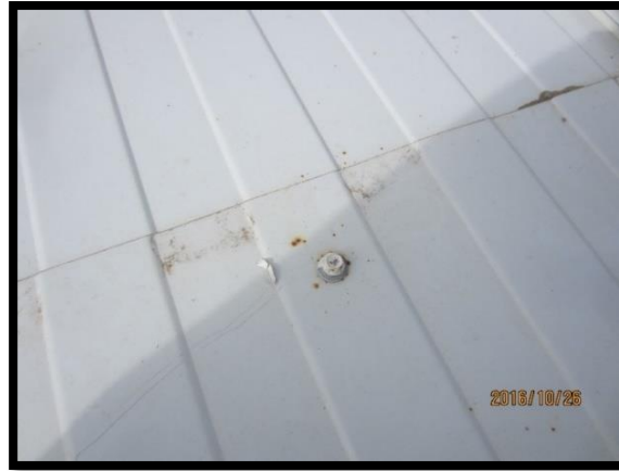
Figura 128 - Identificação de limalhas de ferro na cobertura
