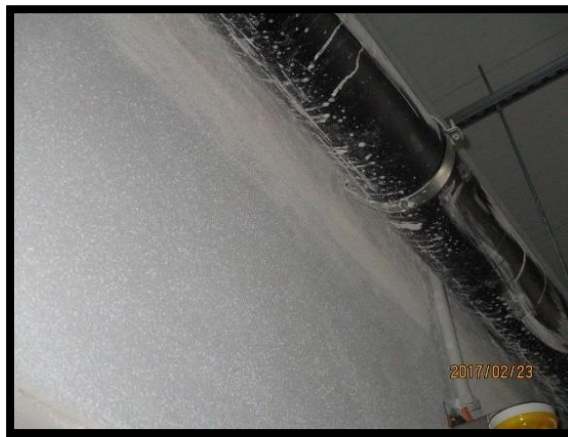
Figura 119 - Patologias identificadas na pintura exterior das caixas de escada do piso 2
