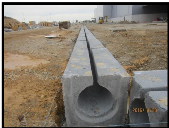
Figura 66 – Pormenor da caleira de balão da rede de drenagem de águas pluviais
