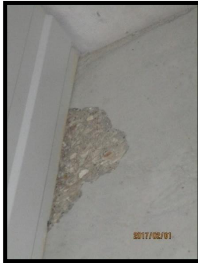
Figura 123 – Patologias identificadas nos pilares pré-fabricados do piso 2
