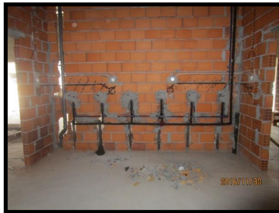
Figura 58 - Rede de abastecimento de água com aplicação de manga na tubagem de água quente para evitar condensações
