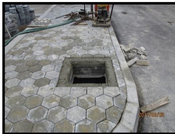
Figura 148 - Ausência de guardas e sinalização na caixa de visita do passeio
