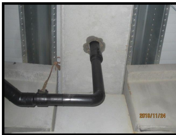
Figura 117 - Infiltrações provenientes do mau isolamento dos ralos da rede de drenagem de águas pluviais
