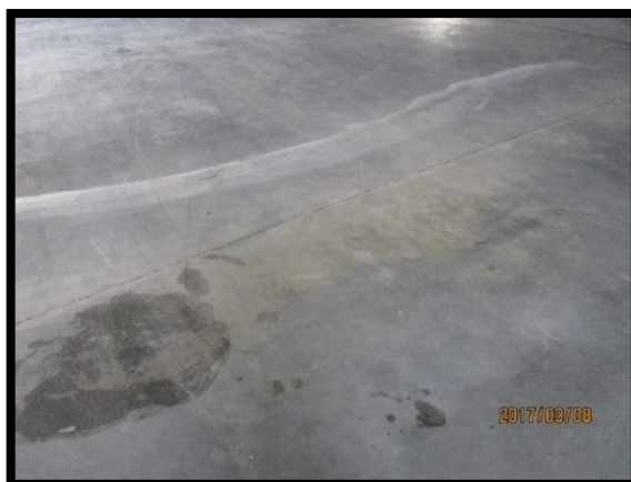
Figura 135 - Identificação de sujidades no pavimento do piso 2
