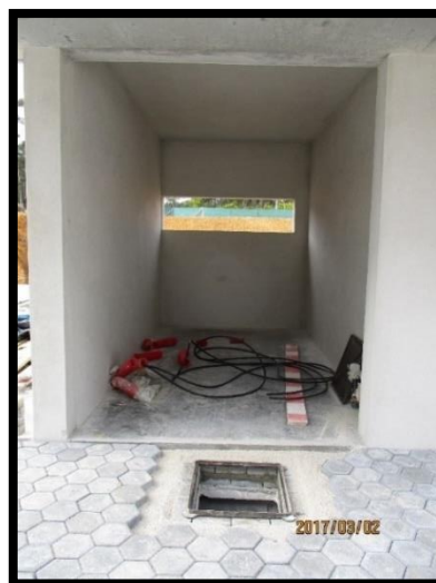
Figura 103 - Revestimento interior do grupo de pressurização
