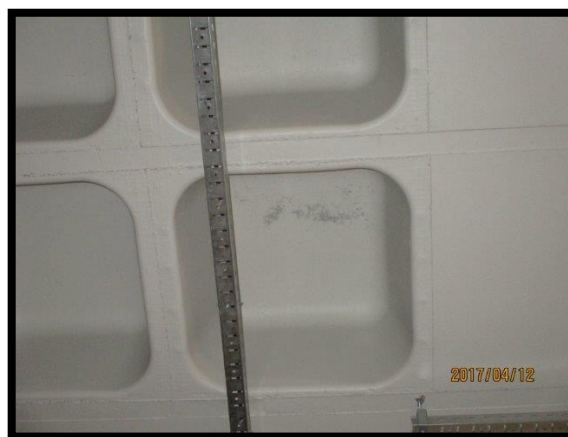
Figura 120 - Patologias identificadas na pintura dos cocos do teto do piso 0
