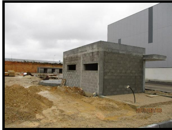
Figura 101 - Construção do edifício do grupo de bombagem e da betonagem do reservatório de apoio do grupo de bombagem de segurança contra incêndio em edifícios
