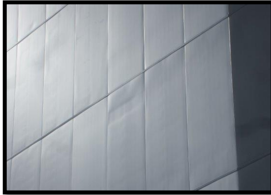
Figura 114 - Patologias identificadas no painel exterior de fachada
