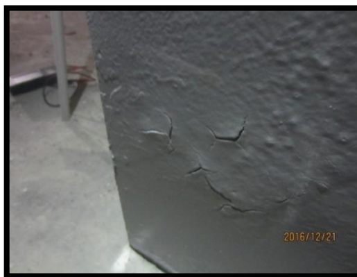
Figura 129 - Identificação de patologias nos pilares metálicos do piso 1
