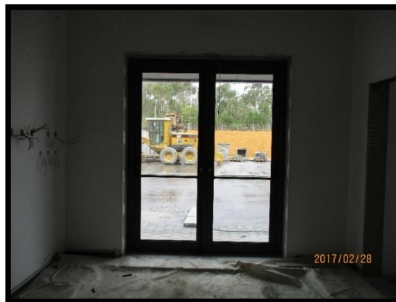
Figura 76 - Aplicação de porta envidraçada na zona administrativa para a zona exterior
