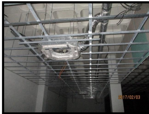
Figura 78 - Montagem das condutas de ventilação do ar condicionado (AVAC) na zona administrativa
