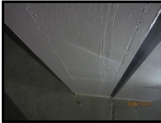
Figura 130 - Identificação de patologias na pintura corta-fogo dos pilares metálicos do piso 1
