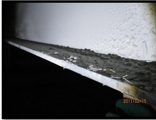
Figura 133 - Identificação de patologias na pintura corta-fogo das vigas metálicas do piso 1
