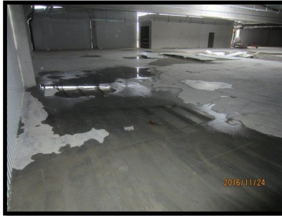
Figura 116 - Identificação de humidades no pavimento do piso 2
