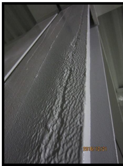
Figura 131 - Identificação de novas patologias na pintura corta-fogo dos pilares metálicos do piso 1
