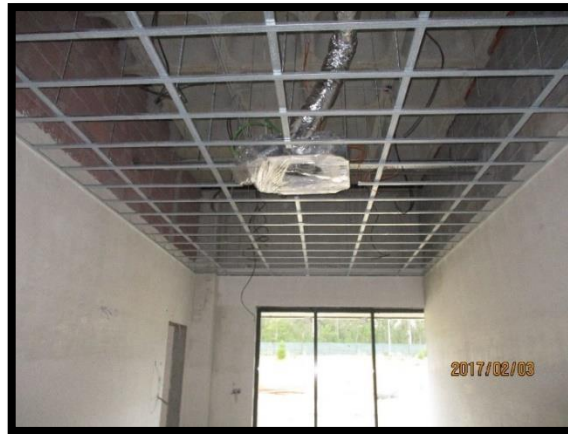
Figura 77 - Montagem das condutas de ventilação do ar condicionado (AVAC) no gabinete do dono de obra
