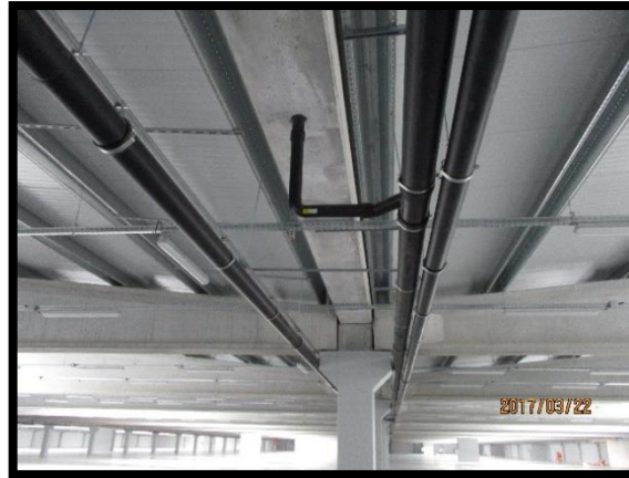
Figura 69 - Montagem dos coletores da rede de drenagem de águas pluviais no piso 2
