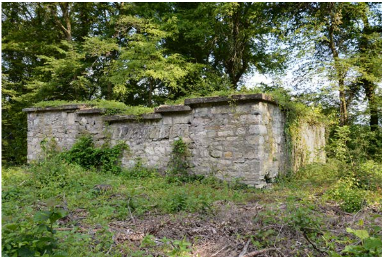
Abb. 3: Koblenz-Kleiner Lauf (AG). Zustand des Wachturms vor der Sanierung im Sommer 2014. Foto: P.-A. Schwarz.
