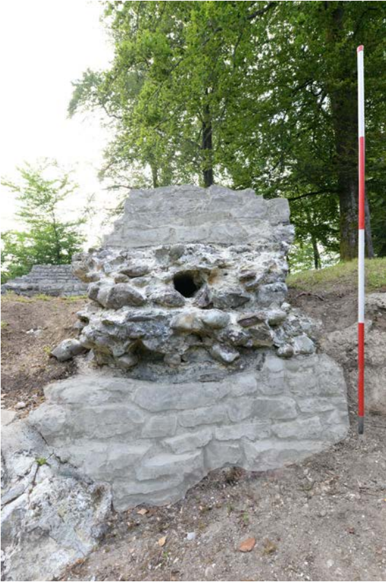
Abb. 7: Möhlin-Fahrgraben (AG). Im antiken opus caementitium sind die Negative der mittleren und obersten Lage der Holzarmierung zu erkennen, darunter die im Text erwähnte Baufuge. Die grau eingefärbten Mauerpartien kennzeichnen die moderne Unterfangsmauer (unten) bzw. moderne Ergänzungen (oben).
