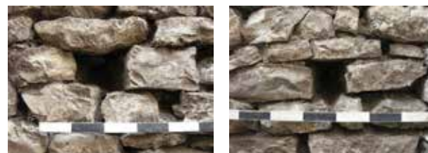
Abb. 8: Kaiseraugst AG, Auf der Wacht (Grabung 2011–2013.001). Schacht MR 6/MR 32 (Zustand im März 2016). Mit modernen Holzbalken markierte Balkennegative in MR 32 und Detailaufnahmen der beiden Balkennegative (vgl. dazu auch Abb. 9).
