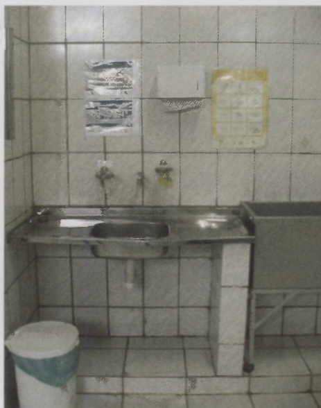
Fig. 8. Detalhe de pia na área de manipulação.
