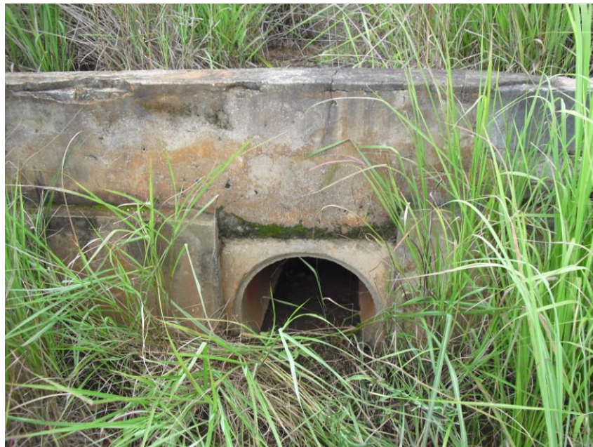
Figura 26: Estrutura de controlo da entrada de água no canal terciário da Unidade do Luínga. (Fotografia do autor, Fev. 2010).
