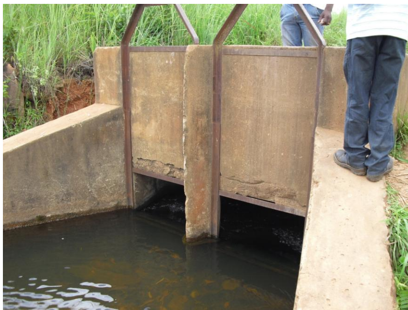
Figura 24: Estrutura de entrada de água proveniente da albufeira no canal principal da Unidade do Luinga.
