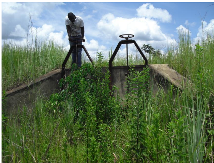
Figura 25: Estrutura de controlo da entrada de água no canal secundário da Unidade do Luinga.
