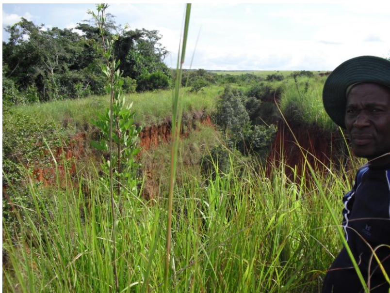
Figura 20 – Ruptura na unidade de rega do Mussabo, provocada pelo desabamento de terras, que impede a água de circular nos canais. (Fotografia do autor, Fev. 2010).
