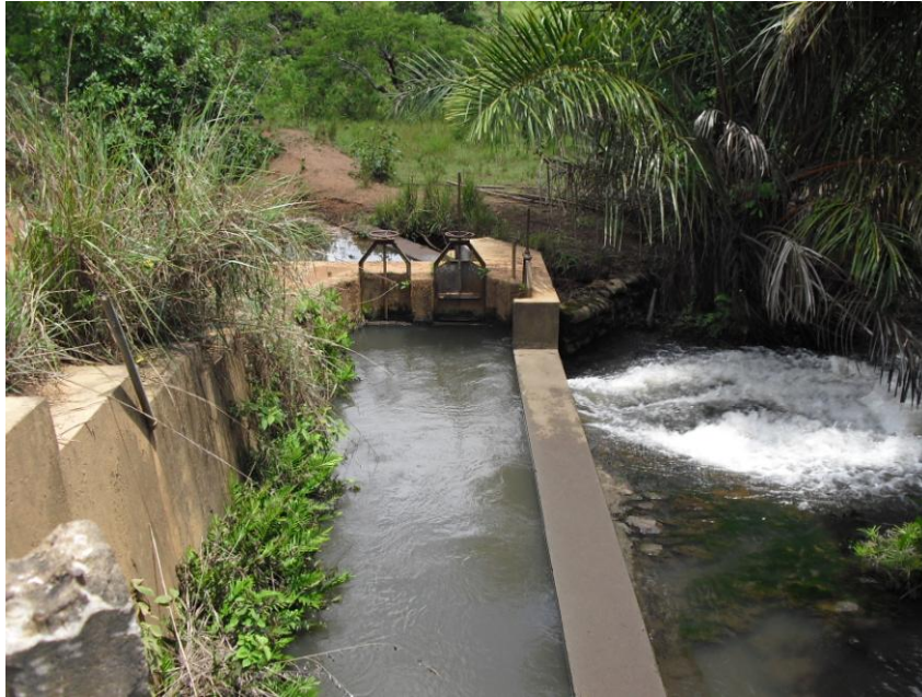
Figura 23: Estrutura de entrada de água proveniente do rio Luinga no canal principal da Unidade do Terceiro Aldeamento.
