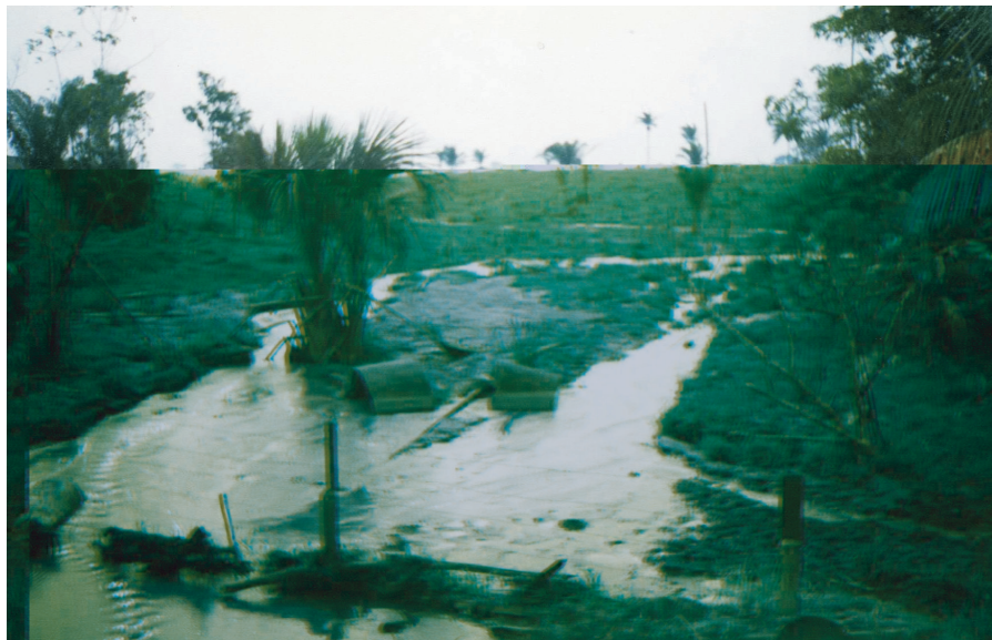
Fig. 2. Estrada cortada e tubulação de concreto arrastada pela força da água como consequência de processos erosivos no PA Lajedo.
