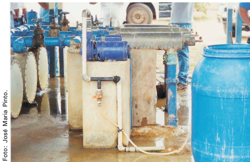
Figura 6. Detalhe de Venturi no cabeçal de controle.
