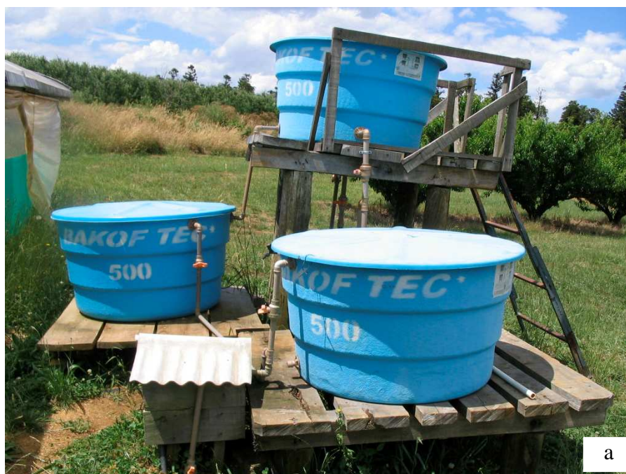
Fig. 9a. Detalhe da ligação entre os reservatórios de água e a moto-bomba.
