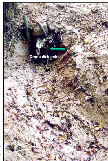
Fig. 7. Detalhe das valetas localizadas à montante do local onde ocorre o "eskorregamento do solo", construídas para conduzir e desviar a água da enxurrada proveniente da área de captação à montante - Pasto degradado.
