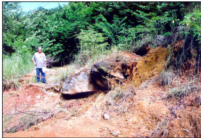
Fig. 6. Detalhe das rochas deslocadas com o arraste da terra no local onde ocorre o "escorregamento do solo" sobre o canal e próximo ao Rio Itabapoana
