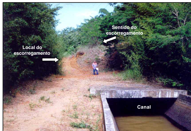
Fig. 1. Detalhe do canal de captação de água coberto com estrutura de alvenaria e, ao fundo, o "escorregamento do solo" sobre o canal.
