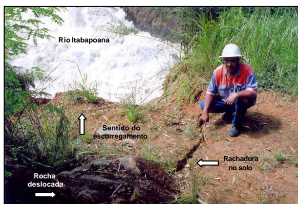
Fig. 10. Detalhe das rachaduras que ocorrem no local do escorregamento do solo próximo ao Rio.
