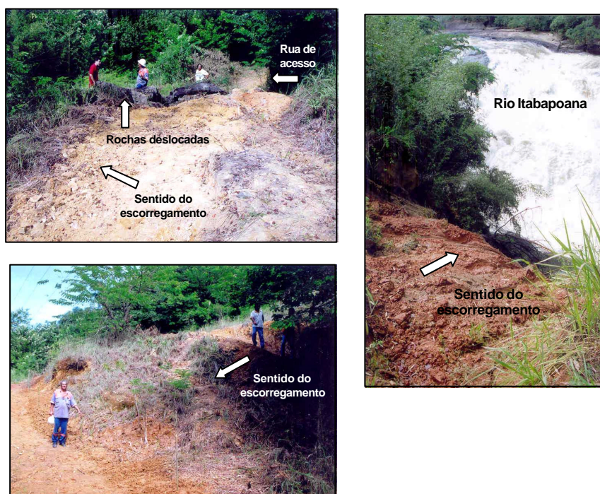
Fig. 2. Detalhe do local onde ocorre o "escorregamento do solo", sobre o canal e próximo ao Rio Itabapoana
