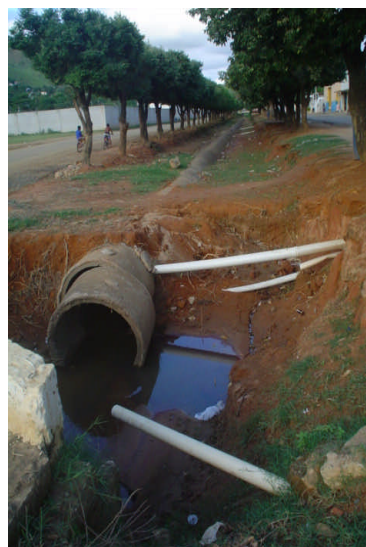
Fig. 43. Córrego Raposo com parte canalizada e lançamento de esgoto. Fonte: DRM-RJ (2004).
