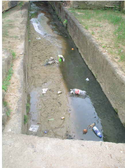
Fig. 51. Esgoto a “céu aberto” canalizado, atravessando a localidade de Ourânia.
