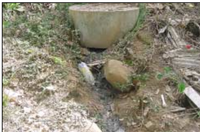
Fig. 35 - Fossa séptica onde é armazenado o esgoto sanitário proveniente da população do distrito de Dr. Loretti com vazamento.
