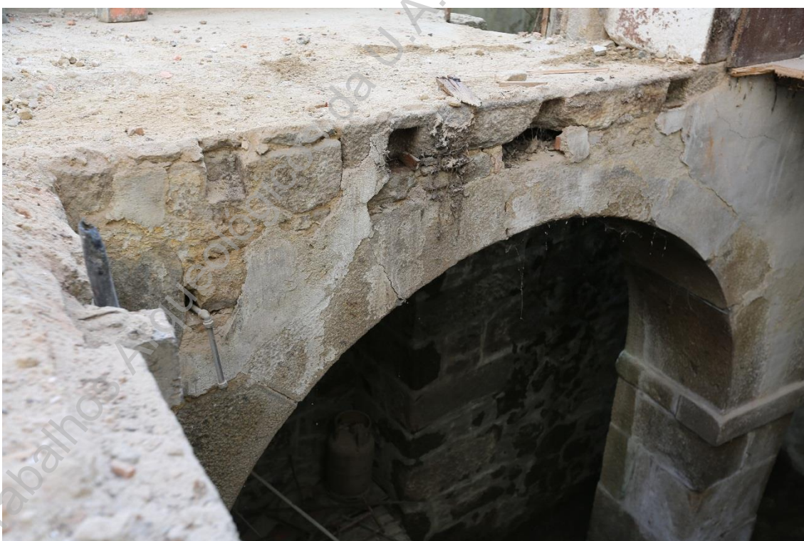
Foto 13: (UAUM-Z45A6039) Pormenor dos encaixes para suportar o soalho do piso1 sobre os arcos (UE011).
