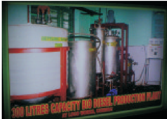
Fig. 27. Reator de transesterificação e tanques de decantação da mini-usina montada pela empresa Loco Works em Chennai, Índia.
