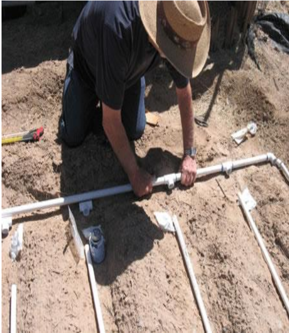
Imagen 11: Sistema de riego por goteo con tuberías de PVC.
