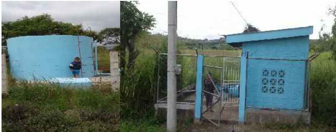
Fig. No 4. Equipo de bombeo y Tanque de almacenamiento Santa Adelaida.
