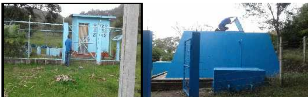
Fig. No 3. Equipo de bombeo y Tanque de almacenamiento La Estanzuela.
