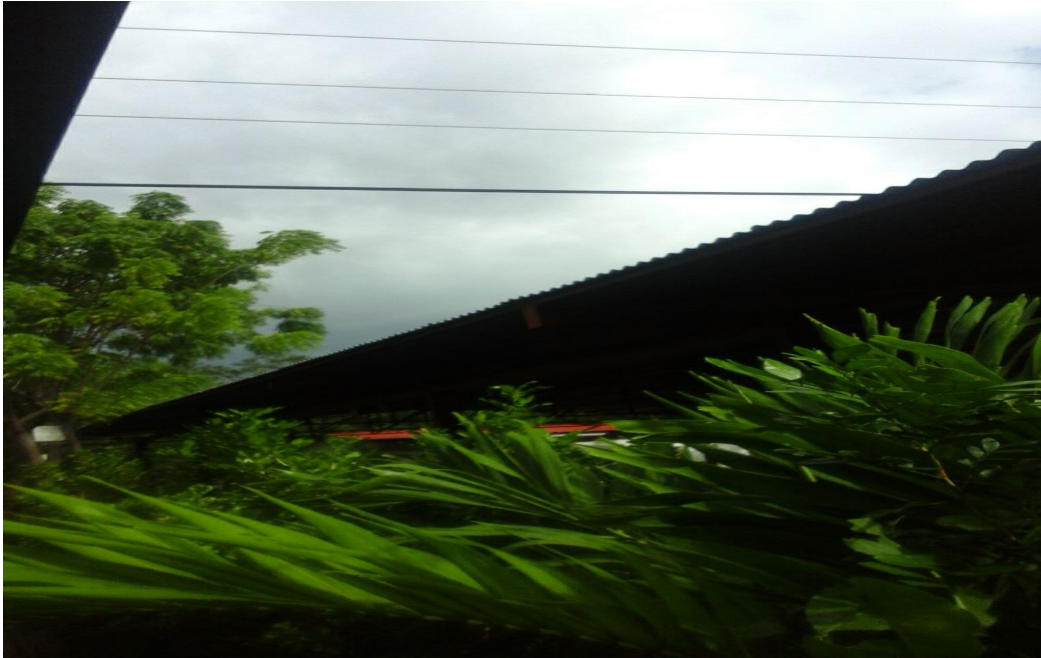
Tendido eléctrico sobre las aulas de clase # 1 y 2
