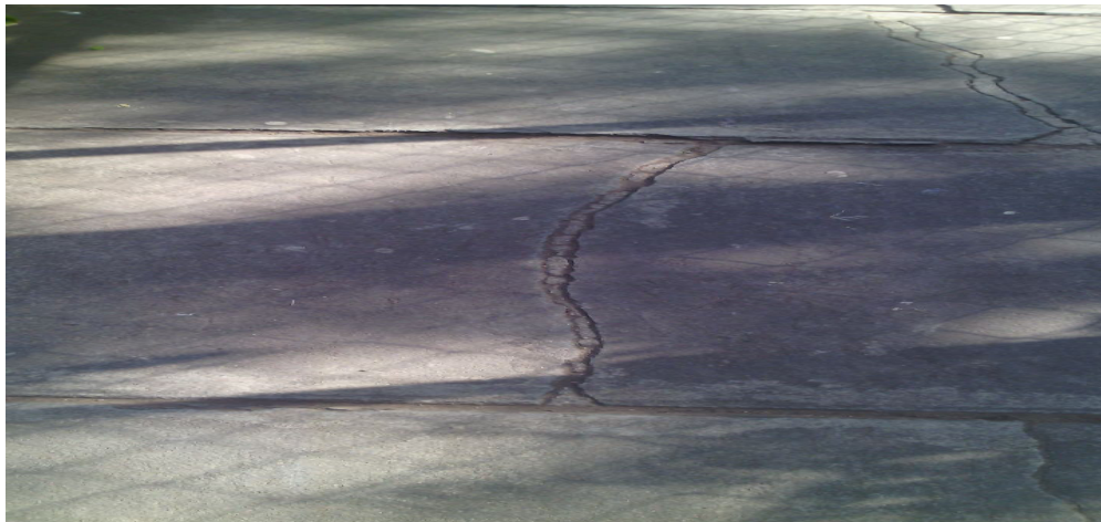
Fisuras en los pasillos ocasionados por movimientos telúricos
