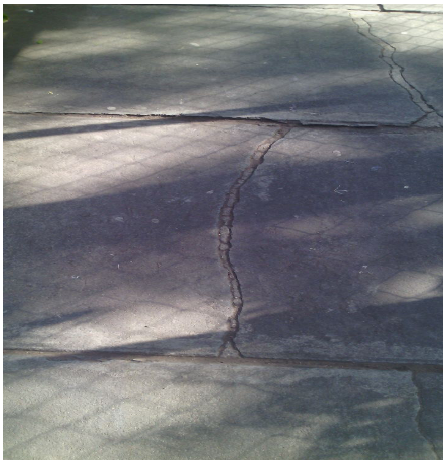
Fisuras en los pasillos ocasionados por sismos
