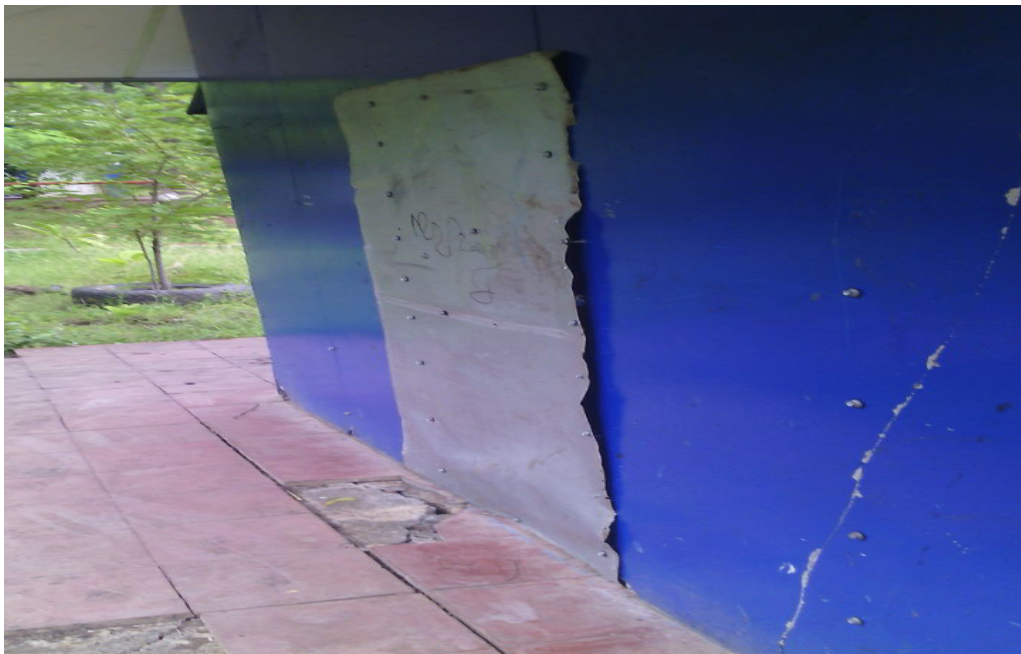
Daños en el quiosco ocasionado por grupos juveniles ajenos al centro escolar
