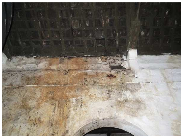
(a) Humidade na parede de empena A
