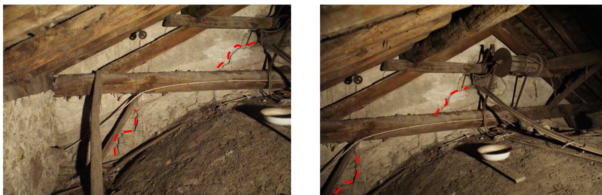
Figura 5.5 – Fissuração diagonal observada na parede de alvenaria suportada pelo arco triunfal.
