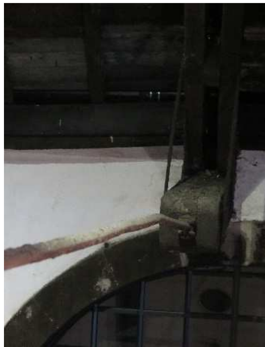
(b) Corrosão e curvatura da linha principal da asna A11
