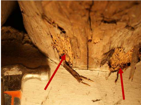
(a) Ataque de térmitas e caruncho na cobertura da capela-mor
