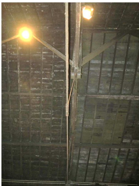
(a) Deformação da zona superior da cobertura na zona da asna 11
