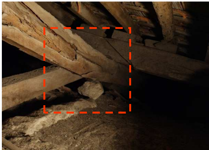
Figura 5.7 – Rotura de perna e apoio na abóbada
