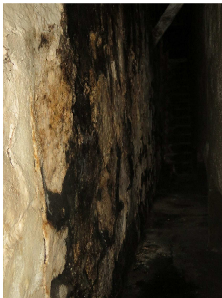
Figura 4.21 – Danos em parede de alvenaria: Presença de humidade na parede da empena A.
