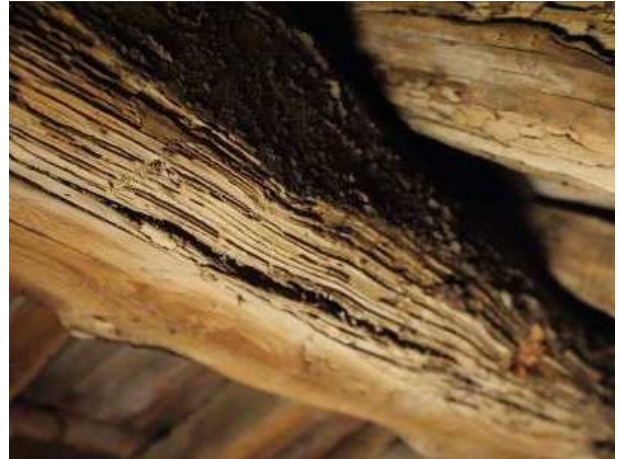
(b) Ataque de térmitas na cobertura da nave.
