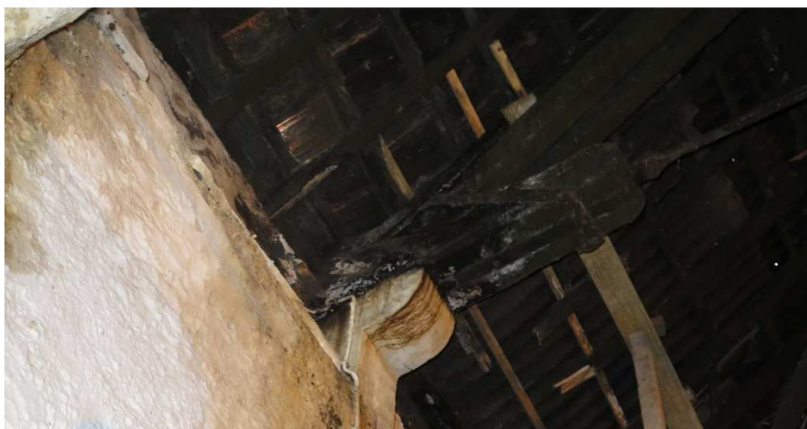
Figura 4.4 – Exemplo de zona com entrada de água abundante e conseqüente degradação.
