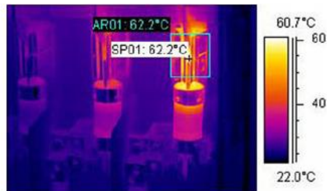
Figura 43 - Imagem térmica em infravermelho de um disjuntor, com medição da temperatura máxima. [20]
