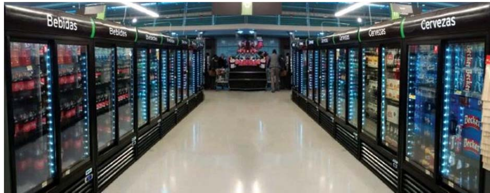
Figura 43. Ejemplo de refrigeración comercial.
