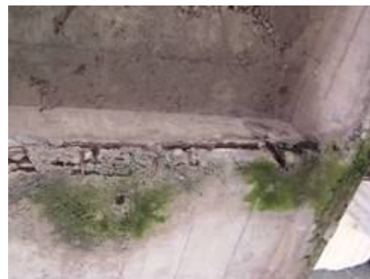
Fig. 15. Armaduras expuestas en losa.
