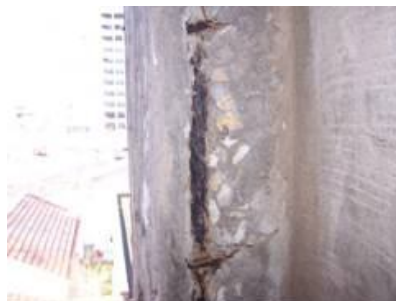
Fig. 14. Armaduras expuestas en columna.
