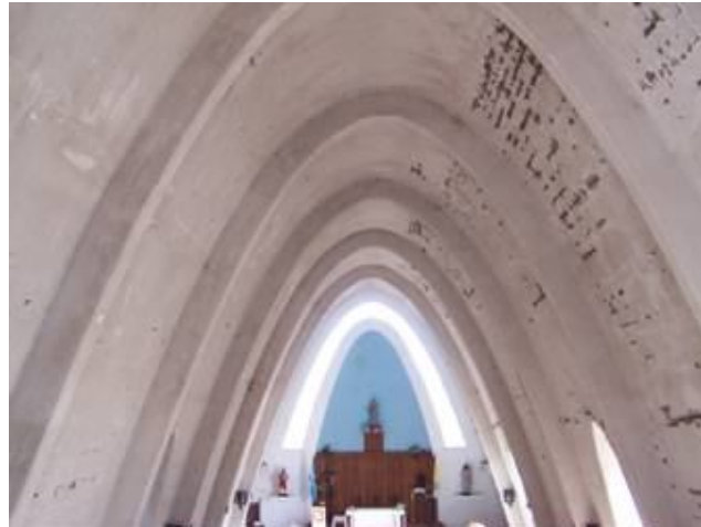
Figura 11. Patrones de desprendimientos del hormigón de recubrimiento 1.5. Análisis de materiales cementíceos
