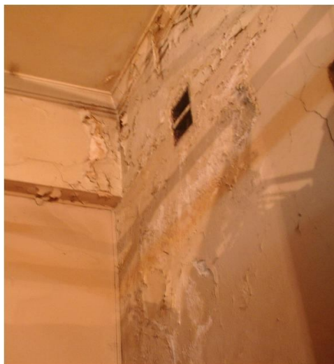
Figura 9: Eflorescencia en paredes y techos
