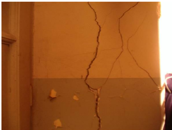
Figura 5: Fisuración en mampostería
