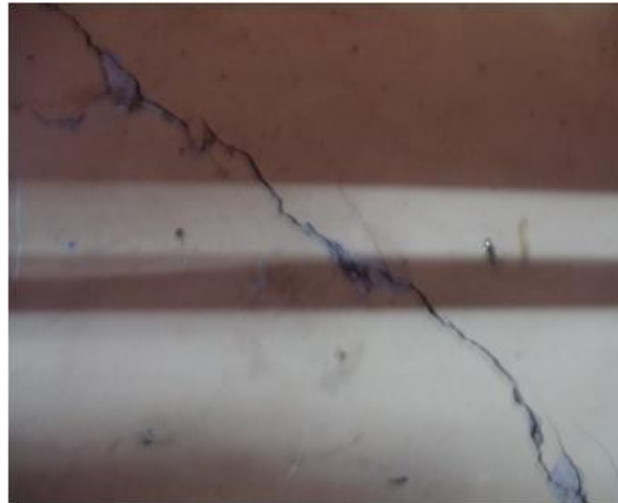
Figura 10: Fisuración por efecto sísmico en mampostería
