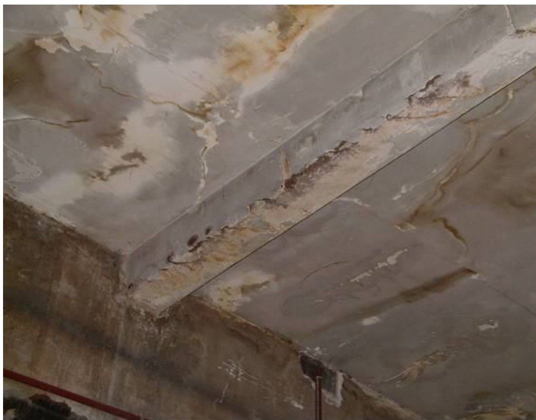
Figura 6: Losas dañadas por efectos de la corrosión de armaduras
