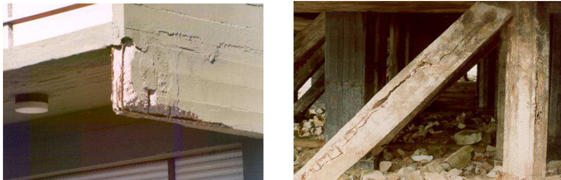
Figura 16. Estructuras en ambientes marinos afectadas por corrosión
