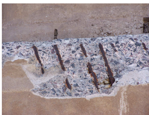
Figura 13. Desprendimientos y disminución de sección por corrosión en puente vial.
