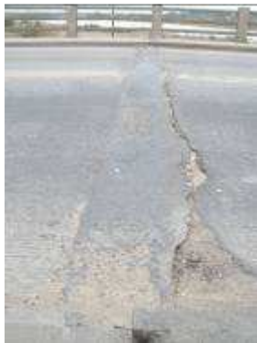
Imagen 26. Junta deteriorada en la carpeta de rodamiento.
