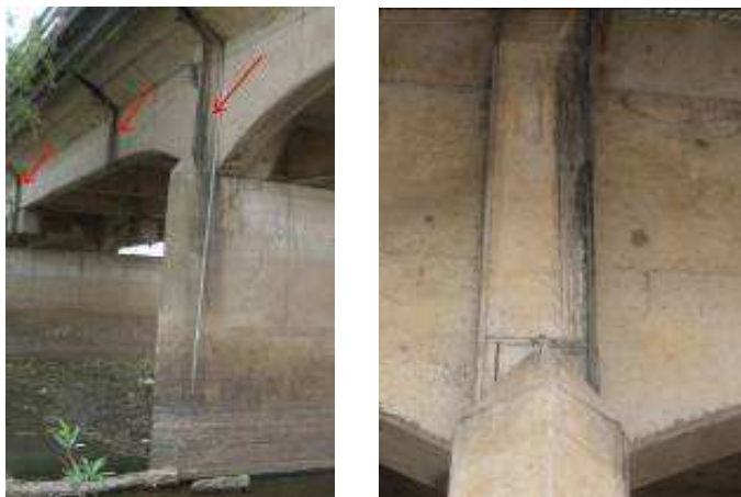
Imagen 33. Filtración de agua por juntas en vereda en voladizo. Deterioro de la viga principal.
