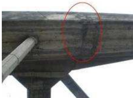
Imagen 20. Arco: desprendimiento de hormigón de recubrimiento en junta (provisoria de ejecución) con corrosión en barra.
