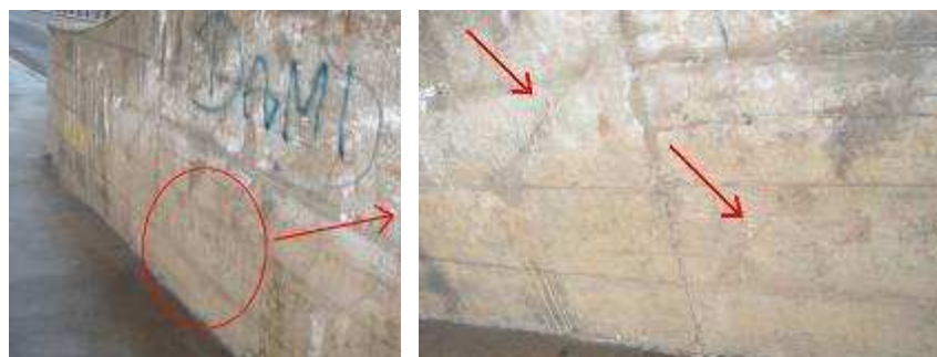
Imagen 18. Fisuras en los arranques de los arcos.
