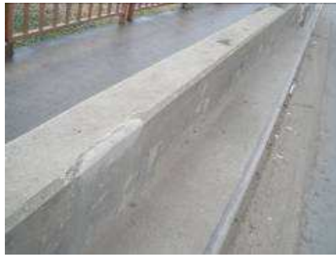
Imagen 24. Arco 1, cadena sur: múltiples reparaciones por desprendimiento de Hº de recubrimiento.
