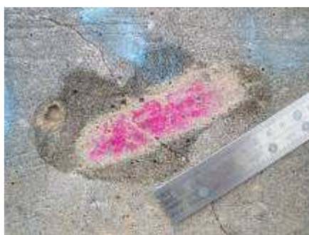
Imagen 13. Determinación de carbonatación sobre fisuras en los arranques.
