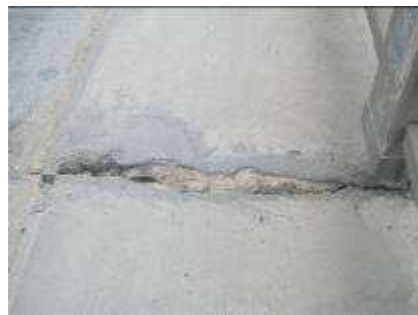
Imagen 27. Junta deteriorada en veredas en voladizo.
