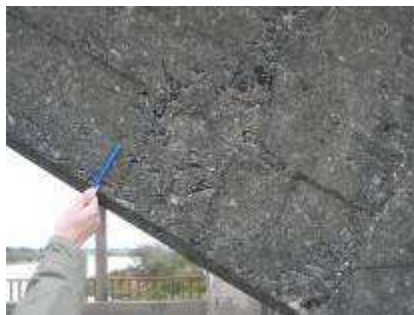
Imagen 21. Hormigón de junta (provisoria de ejecución) mal compactado con oquedades superficiales.
