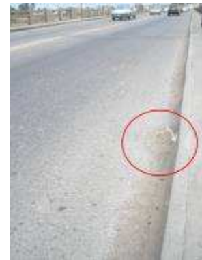
Imagen 28. Carpeta de rodamiento. Desagüe obstruido.
