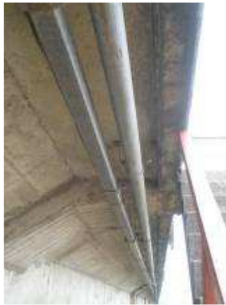
Imagen 30. Escurrimiento de las aguas de lluvia por las vigas laterales de las veredas.
