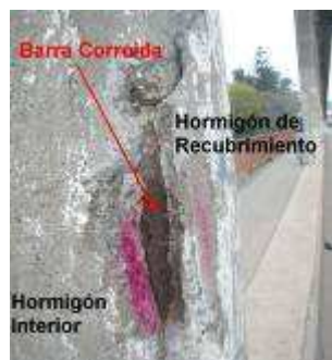
Imagen 12. Determinación próxima a una barra corroída.
