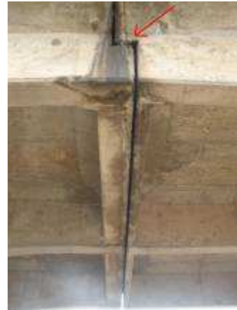
Imagen 31. Filtración de agua por junta en articulación móvil en viga Gerber.
