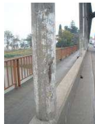
Imagen 22. Péndola, encuentro con cadena: desprendimiento de Hº de recubrimiento y corrosión.
