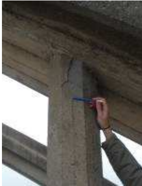
Imagen 23. Péndola, encuentro con arco: fisuración y reparación mal efectuada.
