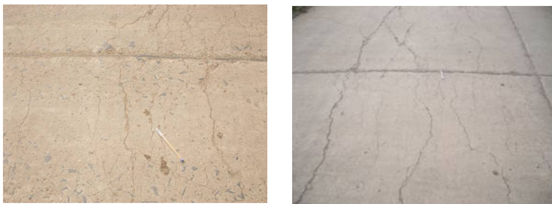
Figura 6. Aspecto superficial de dos losas de pavimento afectadas por RAS donde se observa el cuadro de fisuración con desarrollo longitudinal.
