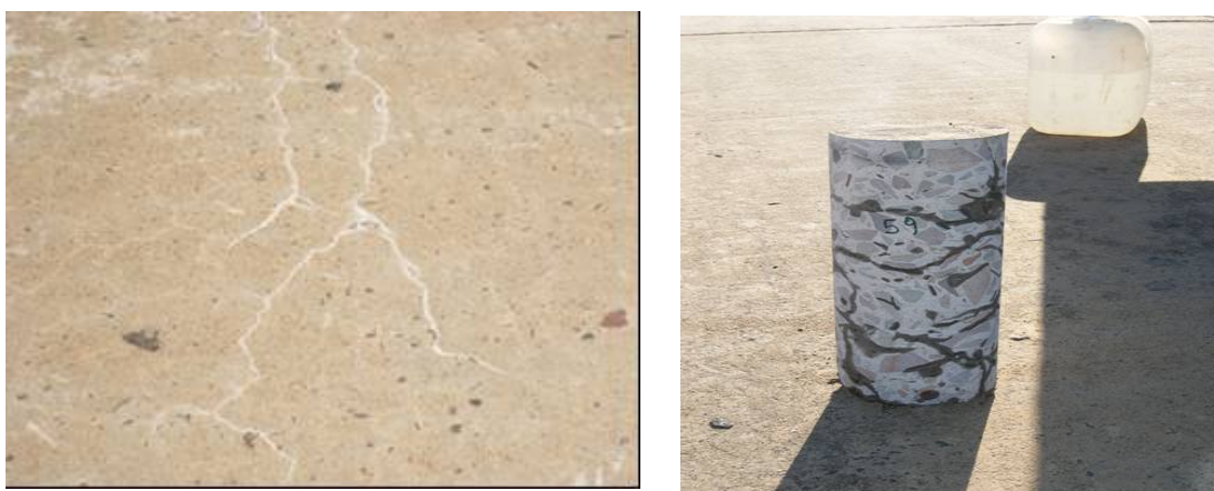
Figura 4. Aspecto superficial de una de las losas afectadas por RAS donde se observa el cuadro de fisuración tipo errático desarrollado y testigo extraído con signos evidentes de deterioro
