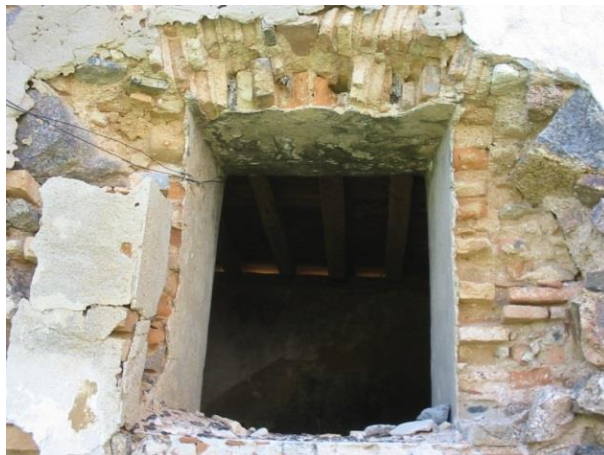
Figura 3 – Problemas patológicos ocasionados pela névoa salina
