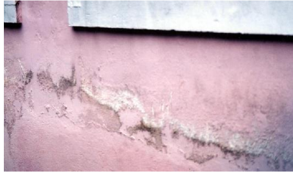
Figura 5 – Parede contaminada pelo lençol freático com sais.
