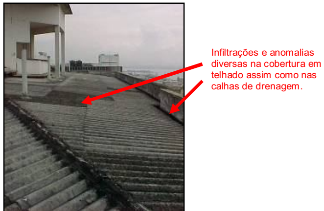
Fotografia 8. Falhas de vedações no telhado e nas calhas coletoras.
