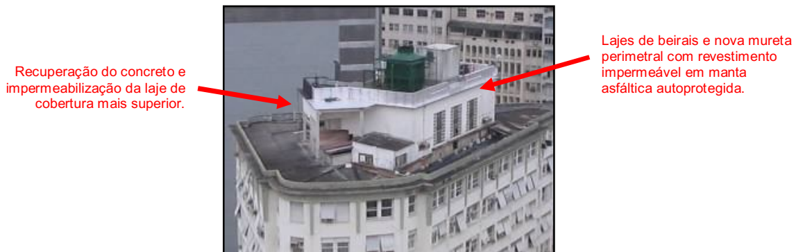
Fotografia 13. Vista da cobertura mais superior ao início das impermeabilizações. Visualiza-se também a cobertura em cota imediatamente inferior ainda com telhado.
