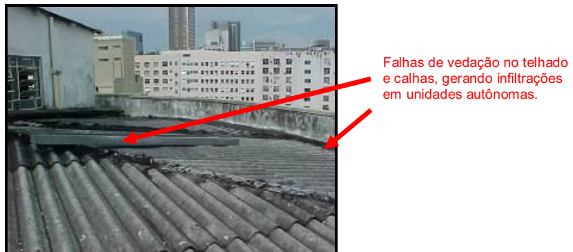
Fotografia 9. Anomalias e estado acentuado de deterioração do telhado.
