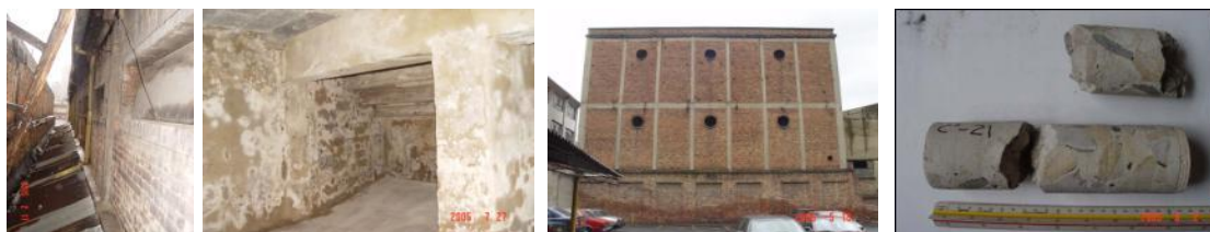
img. 7 Detalles de las estructuras de concreto en los exteriores a la sala. En sótano bajo lobby, en la zona de tramoya. Detalle de un núcleo extraído de una de las columnas para verificar resistencia y composición en laboratorio.
