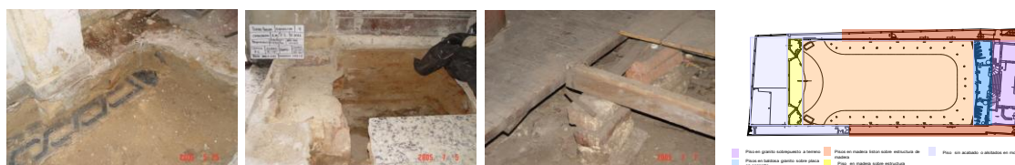
img. 3 detalles de pisos originales y principales componentes en el edificio. Fuente: Estudios preliminares tomo I sistemas constructivos.
