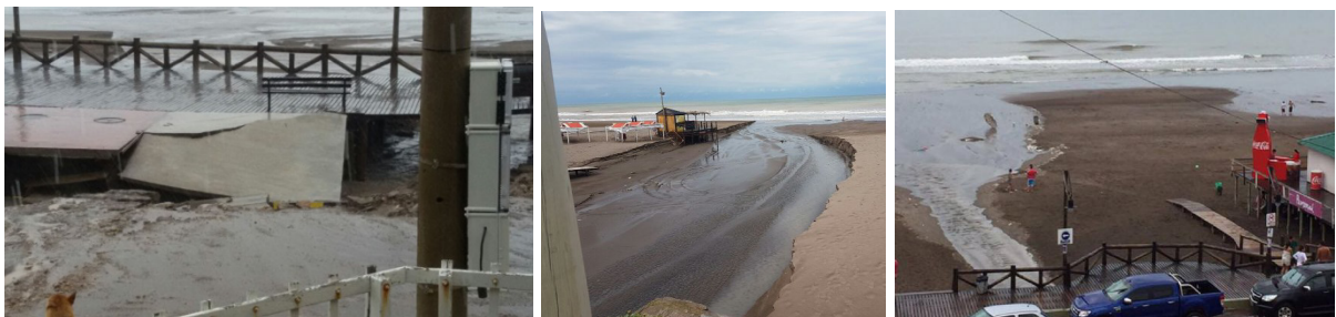
Figuras 8. Inundaciones y socavaciones en las calles sin asfalto
