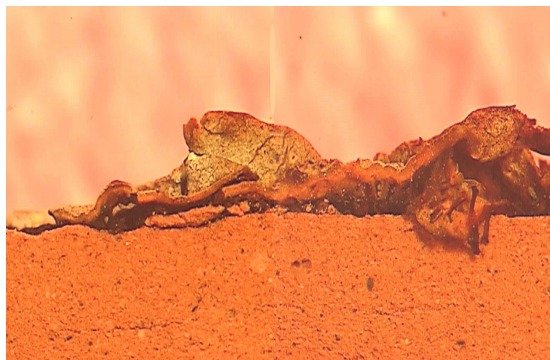
Forma de fijación del liquen sobre la superficie de la teja
