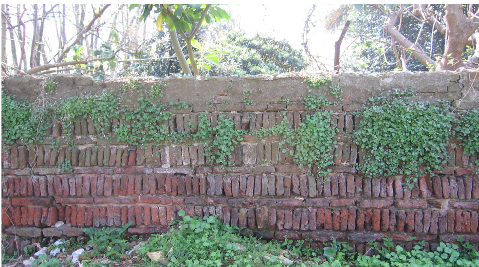
Figura 3 – Muro que se conserva en el antiguo predio de Tomás Basañez edificado con ladrillos de su horno.
