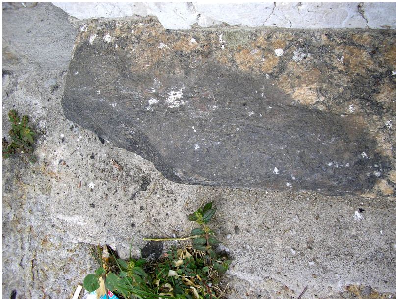
Foto 20 - Vista da pedra olho de boi, manchada por fuligem e cera
