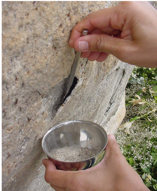
Foto 5 - Retirada de material pulverizado sob a placa em descolamento, para análise em laboratório
