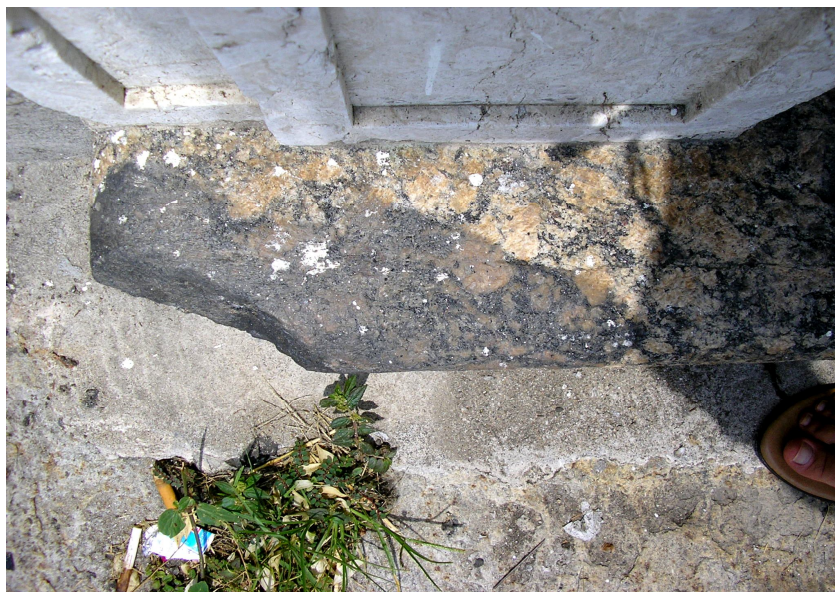
Foto 21 - Após a lavagem a remoção das sujidades superficiais foi mínima
