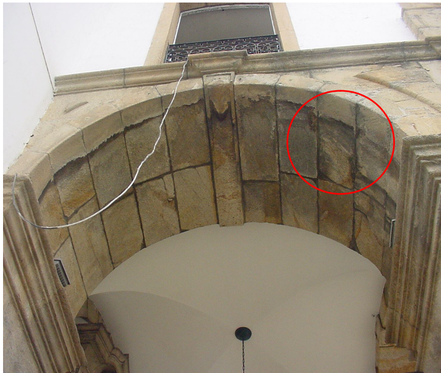
Foto 7 - Arco do pórtico, com faixa clara lavada pela chuva e linha de acúmulo de água, onde ocorrem as crostas negras
