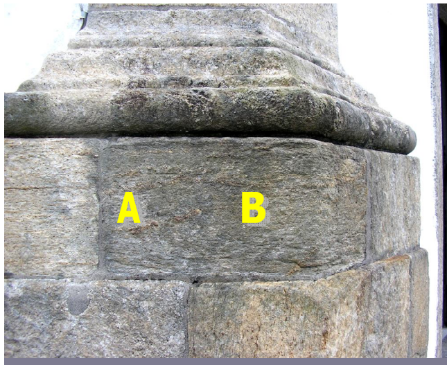
Foto 8 - Vista do cunhal antes de se proceder ao teste de limpeza
