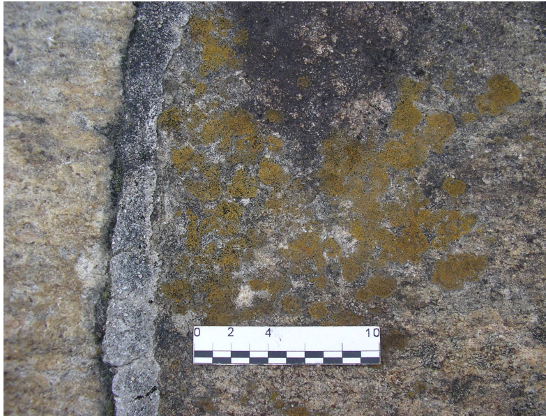
Foto 13 – Vista de líquens sobre a pedra da mureta do adro
