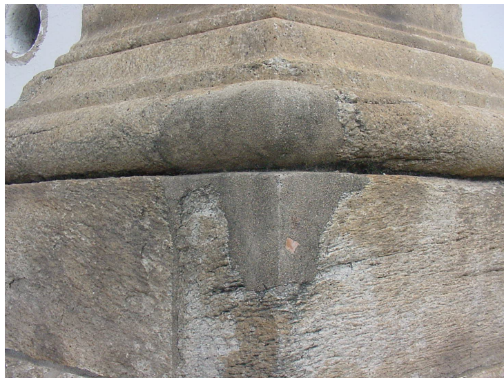
Foto 17 - Detalhe de lacuna no ângulo do cunhal, preenchida com argamassa
