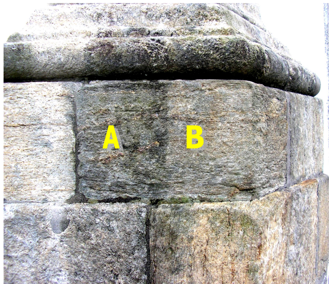
Foto 9 - Vista do cunhal vendo-se a mesma pedra com um trecho limpo e outro mantido como controle.
