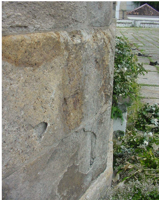
Foto 4 - Vista do descolamento na base dos cunhais externos
