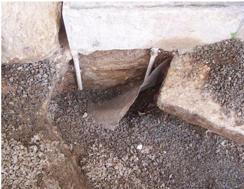
Foto 6 - Vista da câmara de aeração e tubos de ventilação
