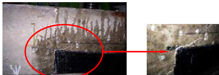
Viga corroída y reparada.
