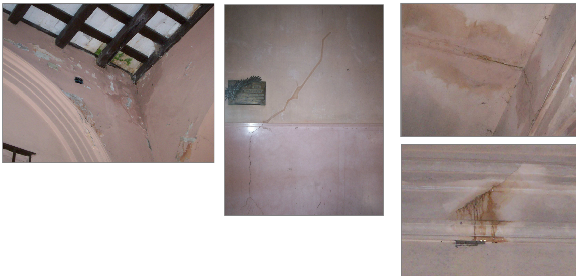
Figura 6. Diferentes vistas de los daños encontrados en la estructura del Colegio.
