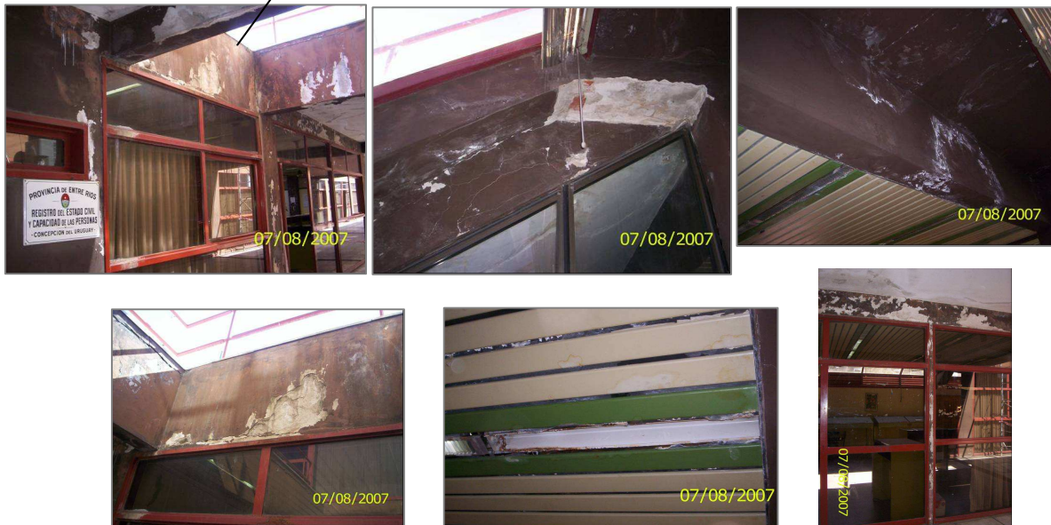
Figura 2. Diferentes vistas de los daños encontrados en la estructura del edificio.
