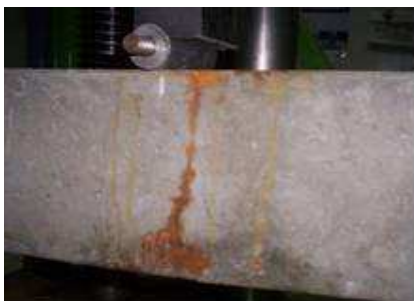
Viga corroída 90 días, sin reparar
