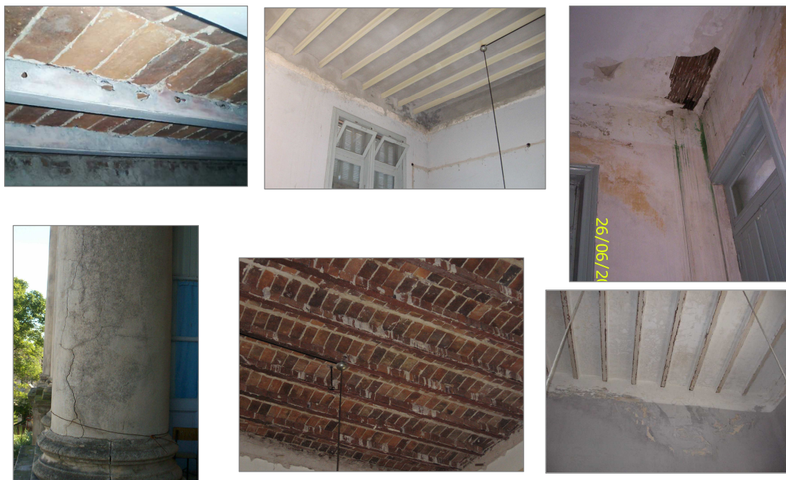
Figura 4. Diferentes vistas de los daños encontrados en la estructura de la Escuela.
