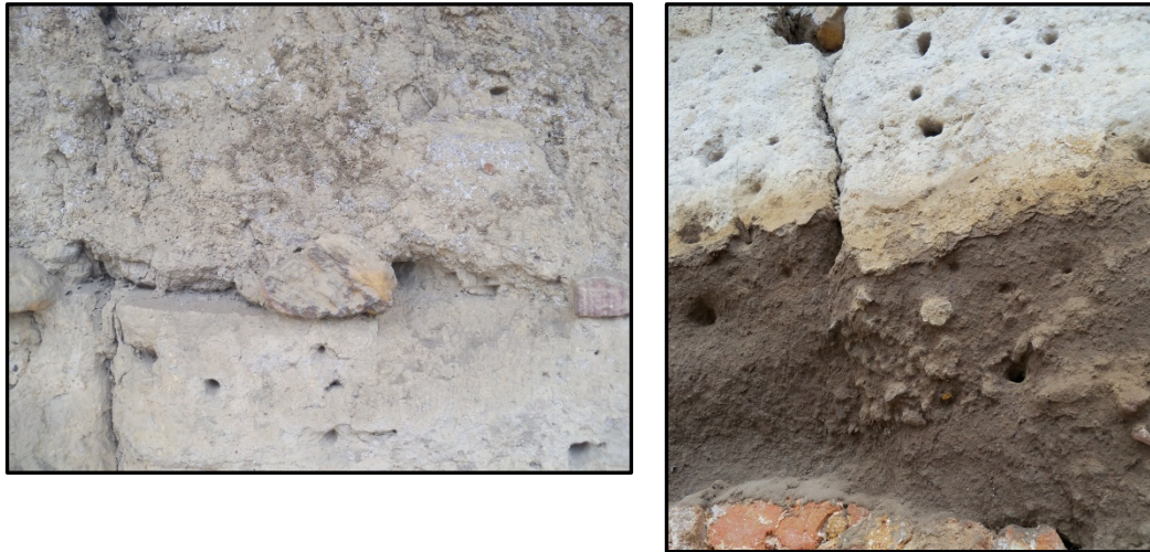
Figura 5. Principales patologías observadas en la tapia pisada del Paredón de los Mártires. (A) Eflorescencias salinas. (B) Humedad en la base del muro por ascenso capilar.
