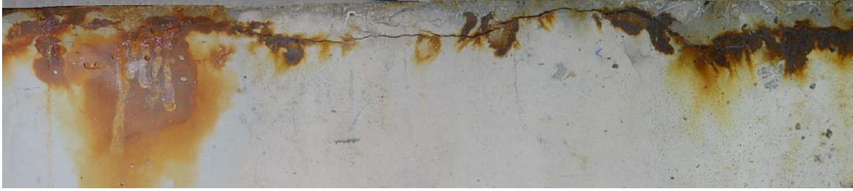
Figura 8.47: Fisura longitudinal lateral de la viga HAN.
