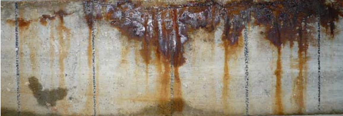
Figura 8.9: Fisuras de la parte central de la viga al final del experimento (las líneas verticales indican la posición de los estribos).
