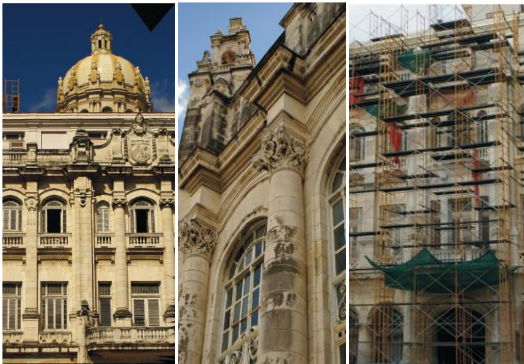
Figura 3 - Vista de distintas fachadas del Museo de la Revolución. Estado de deterioro de la piedra
