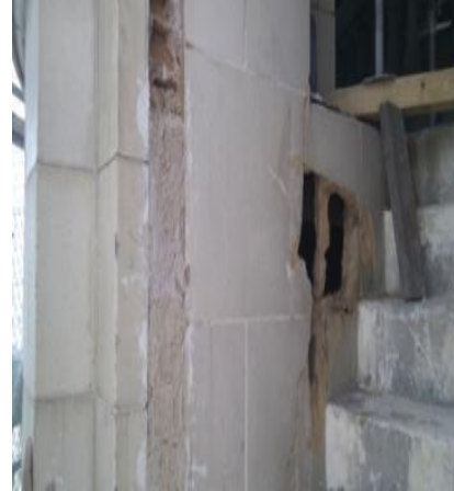
Figura 11- Estado de deterioro elevado de la sección
