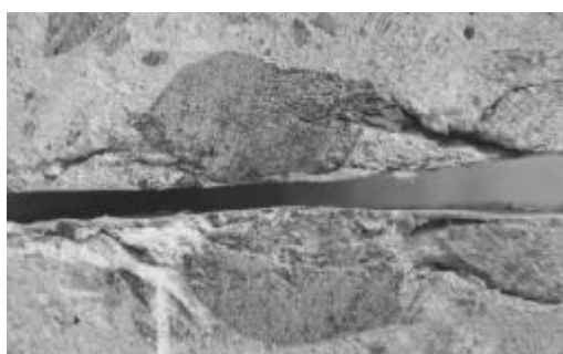
Fotografía 3. Se observan dos trozos de hormigón con clastos de agregado grueso alterado fuertemente adherido al piso polimérico y resto de sales de calcio (mitades enfrentadas)
