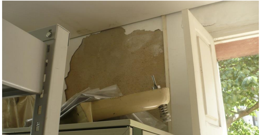
Figura 4 - Eflorescência de sais em um cômodo da instituição. Foto: Camilla Maia
