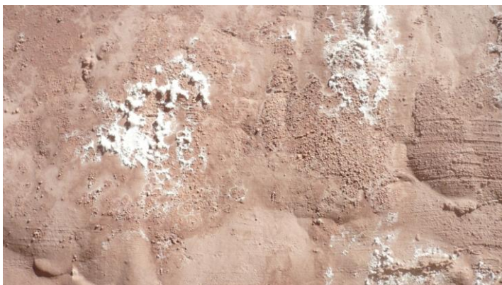
Figura 2 - Ataque biológico por fungo devido à presença de umidade. Foto: Camilla Maia
