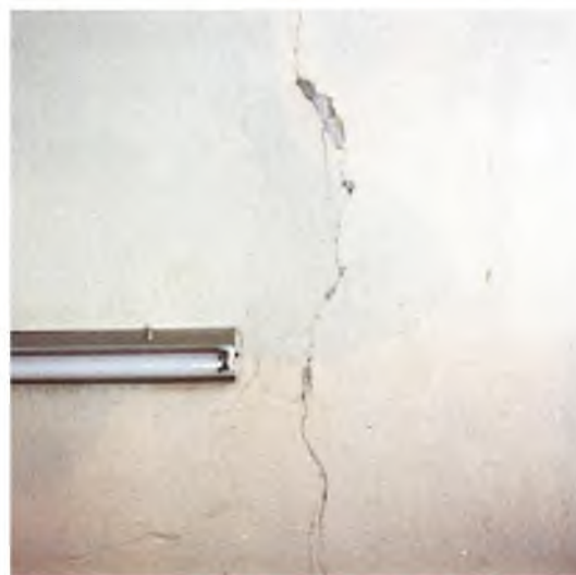
Fig. 49 – Paredes agrietadas por asentamientos
